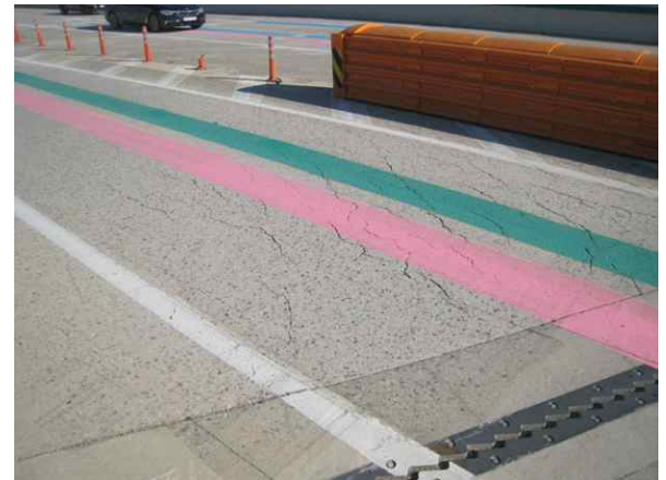
S2 접속도로 망상균열(5.5m x 4.0m)
